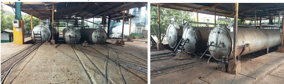
Imagen 1. Autoclaves planta extractora
