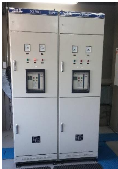
Imagen 20. Tableros GBCP1 y GBCP2
