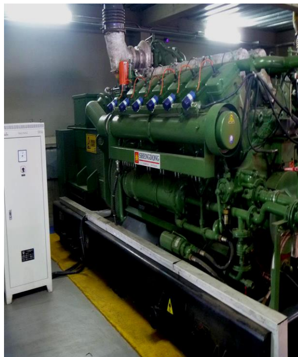
Imagen 22. Moto generador de 750 KW
