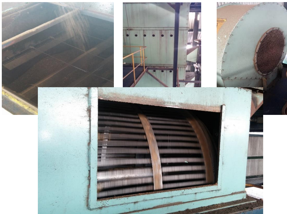
Imagen 12. Silo de secado de nueces, ventilador y tambor separador
